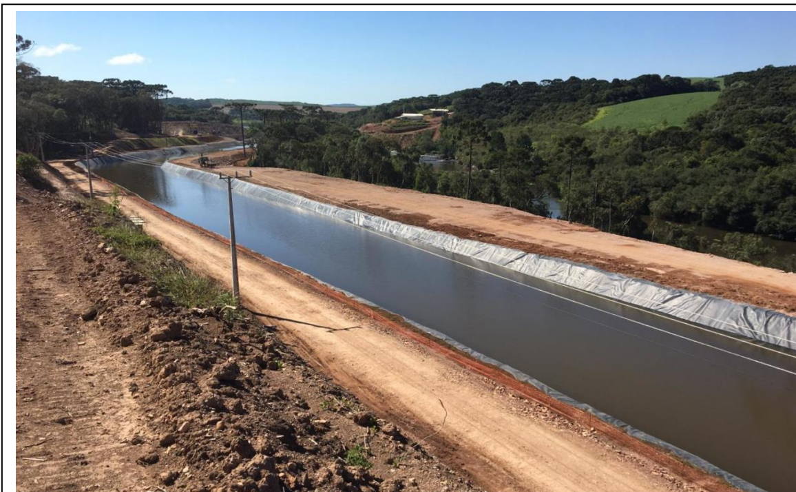
Figura 12 Canal de adução revestido por membrana impermeabilizante, que impossibilita a escalada de animais que acidentalmente venham a cair, terá grade protetora. Adequada.
