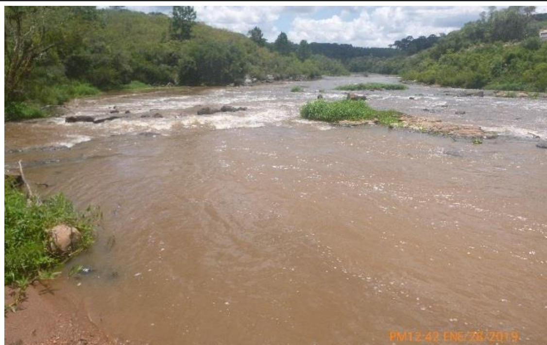
Figura 17 A turbidez indica o carreamento das partículas de solo solto da área da obra.
