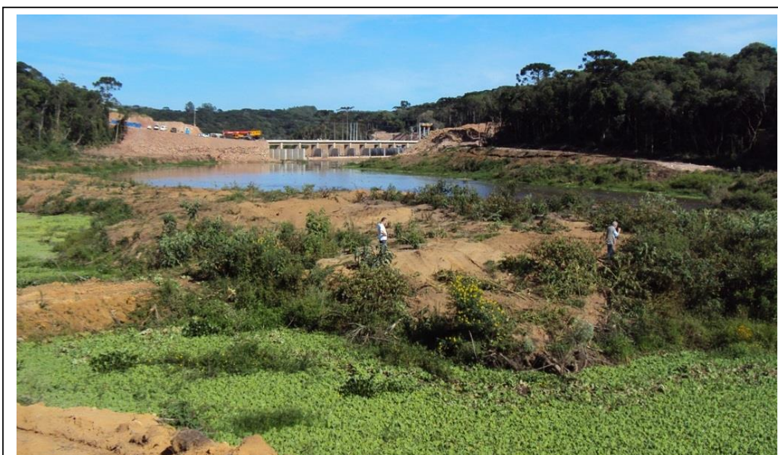
Figura 4 Equipe realizando investigação em ilha próxima à margem. Nota-se no lado esquerdo da imagem a conexão de terra feita por maquinário.
