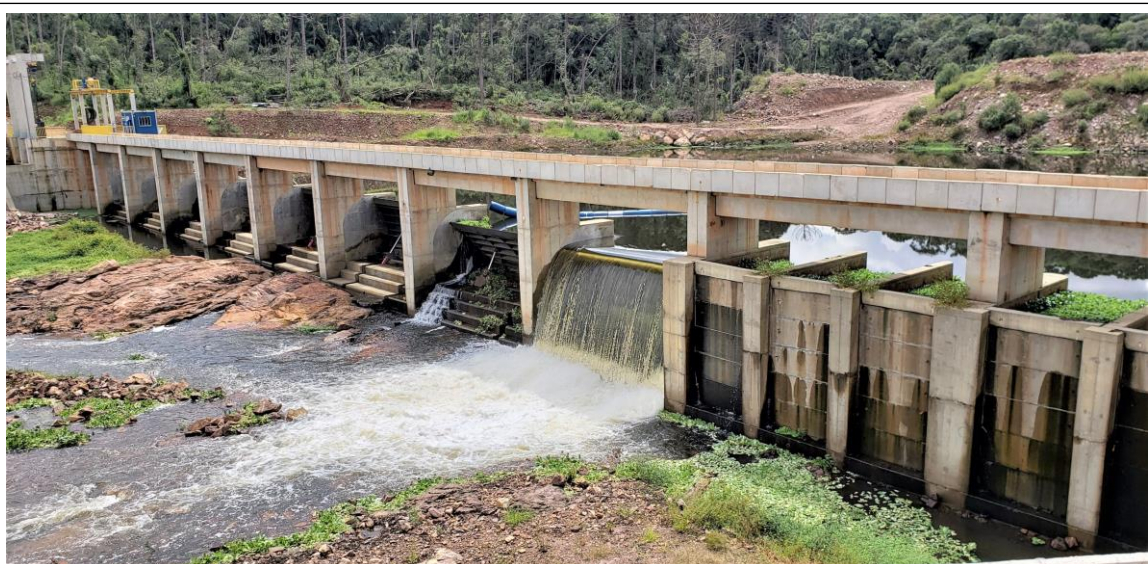
Fig. 11 Operação de descarga de macrófitas pela comporta basculante, reduz pressão, mas não soluciona.
