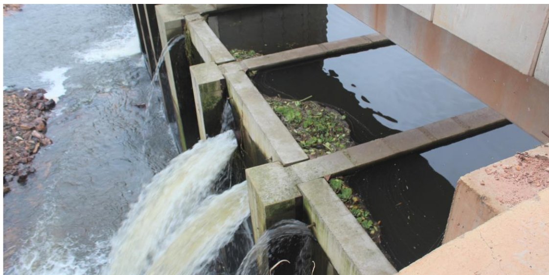
7. .Adufas da vazão ecológica, junho de 2019, substituídas pela escada de peixes
